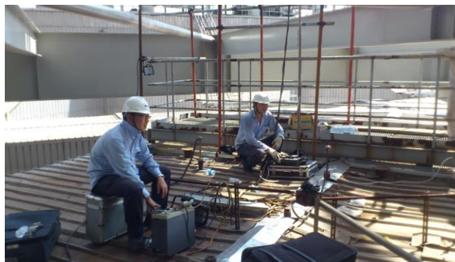
电厂除尘进口取样
